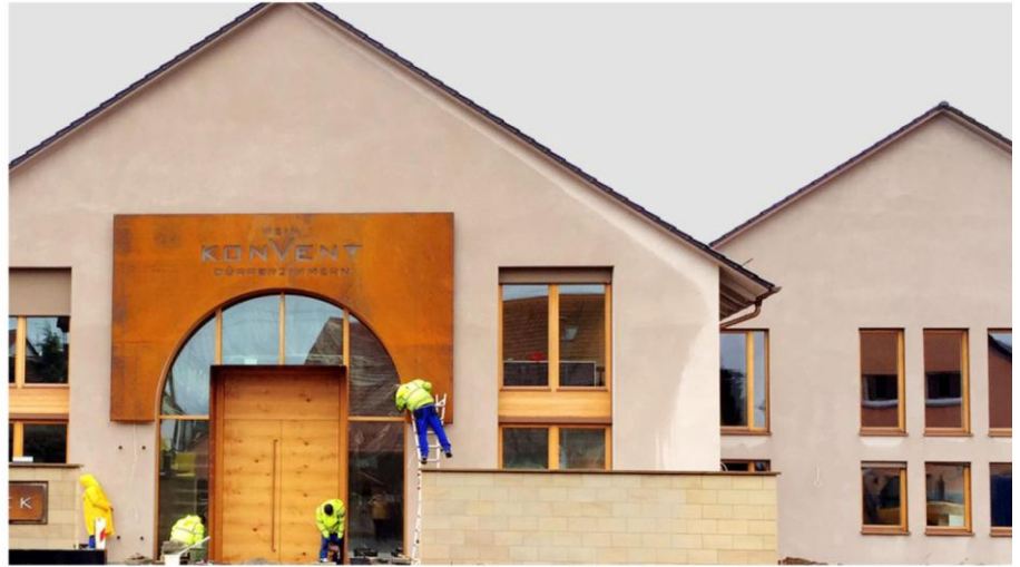
Arbeiter legen letzte Hand an: Der Dürrenzimmerner Weinkonvent stellt seinen gelungenen Umbau beim Tag des offenen Kellers am Wochenende vor.
