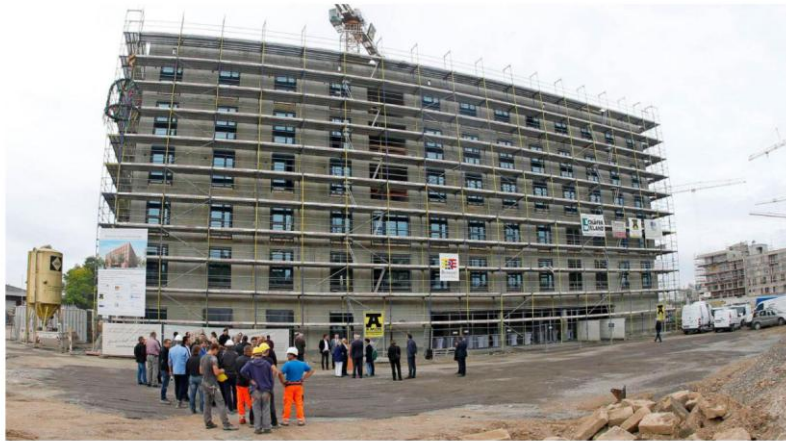
Die neue Jugendherberge steht im Rohbau. Am Freitag wurde Richtfest gefeiert. Den Richtspruch sprach Polier Larry Frey von der Firma Amos. Fotos: Herbert Schmerbeck
